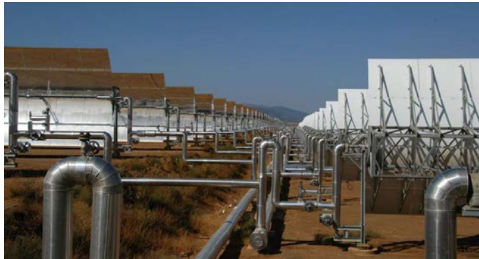
Abbildung 2: Parabolrinnensolarfeld des Kraftwerks AndaSol 3
